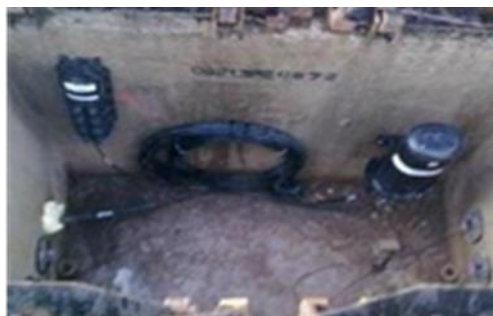
Imagen 22. Vista interior de un pozo con empalmes y cable de reserva.
