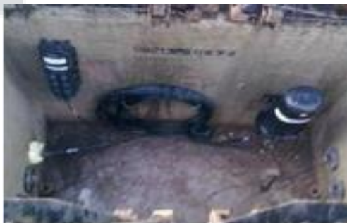
Fig. Vista interior de un pozo con empalmes y cable de reserva.
